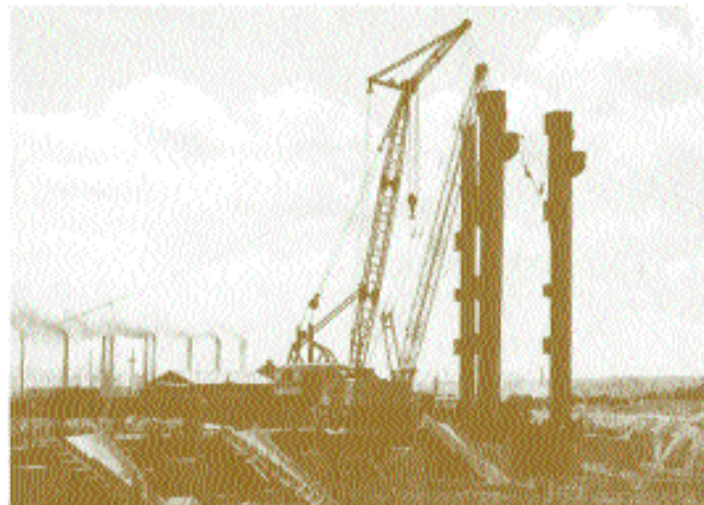
Rys. 1. Stawianie słupów nośnych pierwszego kotła w Elektrowni Turów (w tle widoczne kominy położonej w NRD Elektrowni Hirschfelde )
