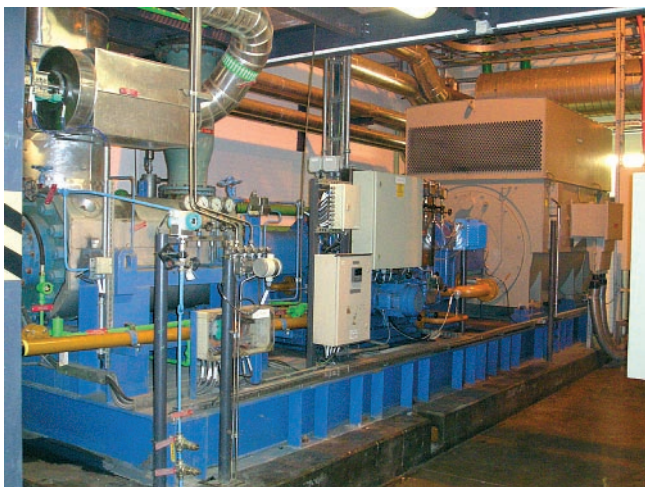
Pompa wody zasilającej
