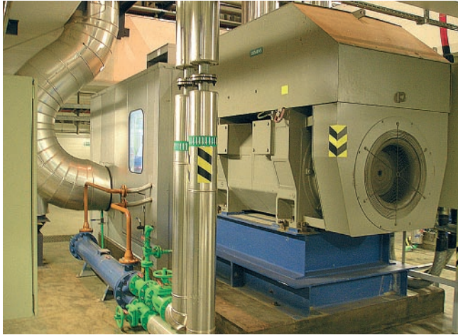
Pompa cyrkulacyjna wody grzewczej
