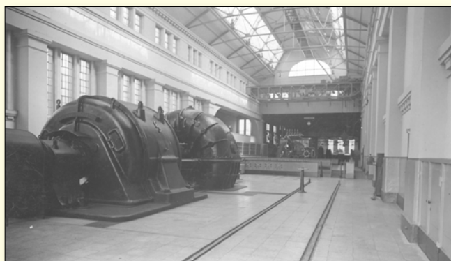
Maszynownia Elektrowni Chorzów w latach trzydziestych
