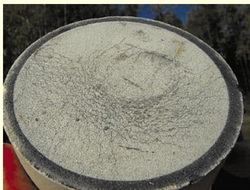
Rys. 7. Elementy iskiernikowego ogranicznika przepięć 220 kV zdemontowanego po stwierdzeniu na jego powierzchni izolacyjnej miejscowych przyrostów temperatury
