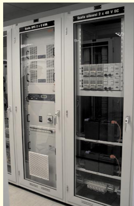
Rys. 3. Falowniki 230V AC APS oraz siłownie 48VDC TelZAS SCU-50
