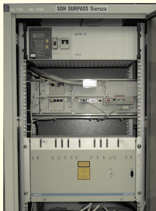
Rys. 2. Węzeł teletransmisyjny Surpass + FMX III
