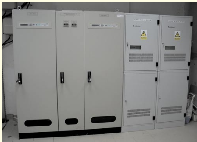
Rys. 4. Falowniki Medcom FPM 8Z oraz siłownie TelZAS SCU90 w SE Łośnice
