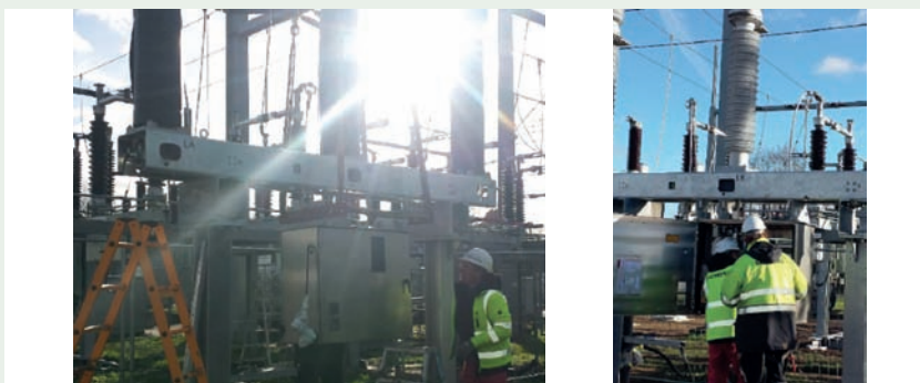
Rys. 24. Instalacja wyłącznika próżniowego na stacji Noerdlingen
