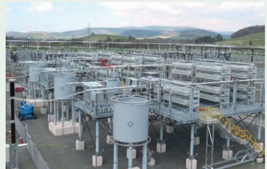
Rys. 7. Urządzenia kompensacji szeregowej z pasywnymi filtrami do tłumienia rezonansu subsynchronicznego [12]
