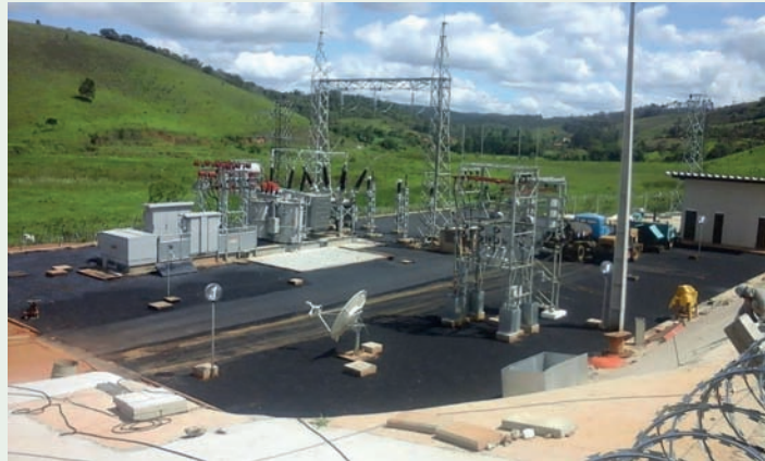
Rys. 1. Stacja kompaktowa – widok ogólny
