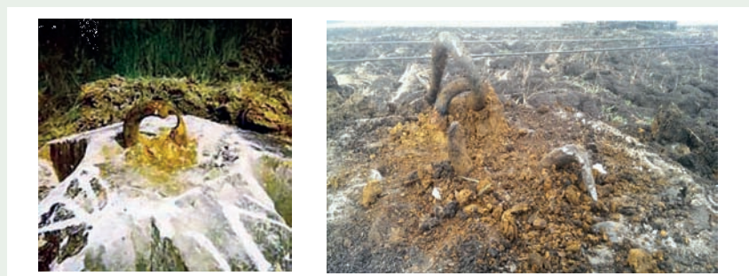
Rys. 20. Przykładowe zdjęcia korozji kotew dla lin odciągowych
