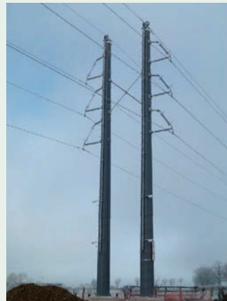
Rys. 25. Słup kompozytowy na linii 110 kV
