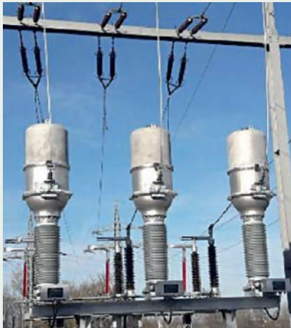
Rys. 23. Przekładnik kombinowany 123 kV typu SVAA z medium izolacyjnym „clean air”. Przekładnik przeszedł z wynikiem pozytywnym próby typu zgodnie z normą IEC 61869
