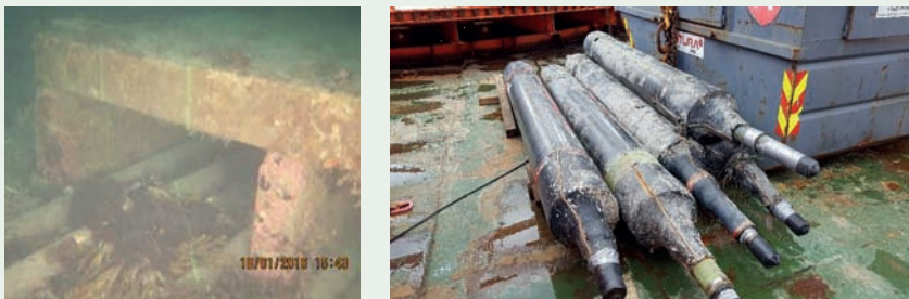
Rys. 2. Linia kablowa chroniona płytami betonowymi oraz 5 usuniętych muf kablowych [B1-119]
