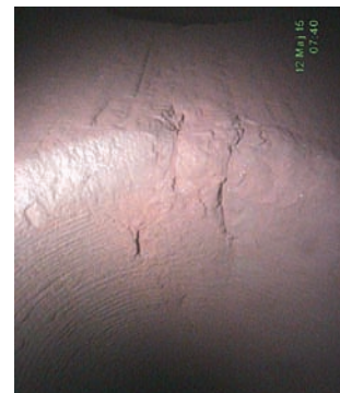
Rys. 11. Pęknięcia krawędzi otworu w komorze wylotowej przegrzewacza pary świeżej jako rezultat zwiększonej liczby i prędkości uruchomień bloku ze stanu gorącego Źródło: opracowanie własne
