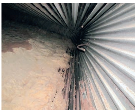
Rys. 12. Szlakowanie rur ekranowych jako rezultat spalania biomasy oraz pracy kotła z licznymi uruchomieniami i obniżonym minimum technicznym
