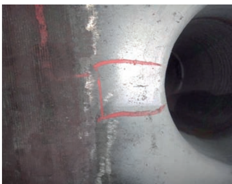
Rys. 9. Pęknięcia na krawędzi otworu pod rurę opadową w strefie wodnej walczaka Źródło: opracowanie własne
