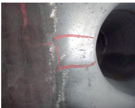
Rys. 9. Pęknięcia na krawędzi otworu pod rurę opadową w strefie wodnej walczaka Źródło: opracowanie własne
