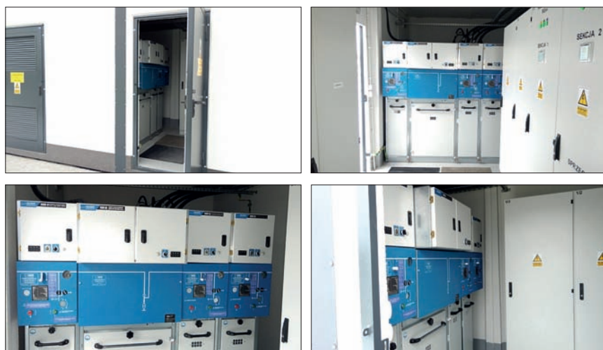
Rys. 5b. Pierwsza krajowa instalacja rozdzielnic HMH
