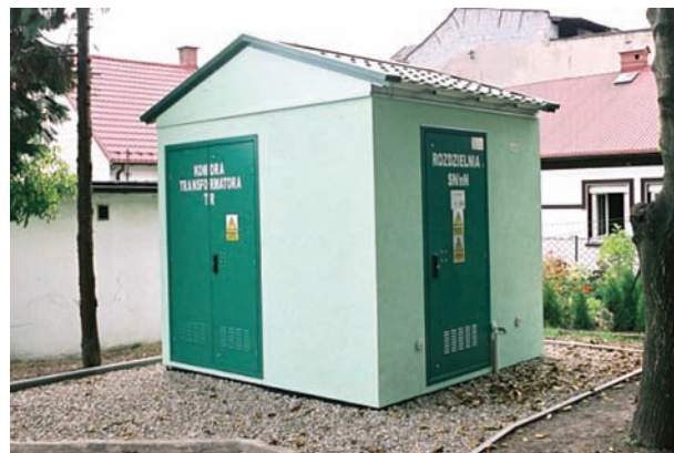
Rys. 1. Kontenerowa stacja transformatorowa [9]
