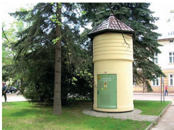
Rys. 2. Stacja transformatorowa typu słup ogłoszeniowy [14]
