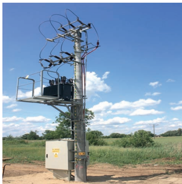
Rys. 3. Stacja transformatorowa słupowa
