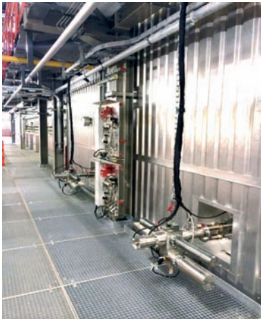
Rys. 4. Shock Pulse Generator – instalacja pozioma
