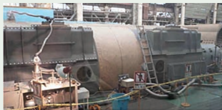
Rys. 6. Generator of mocy 600 MVA z technologią HHT
