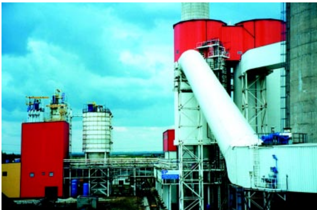
Instalacja Odsiarczania Spalin w Elektrowni Siersza SA
