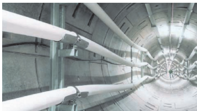
Rys. 5. Linia dwutorowa kablowa 400 kV w Berlinie — kable o izolacji XLPE
