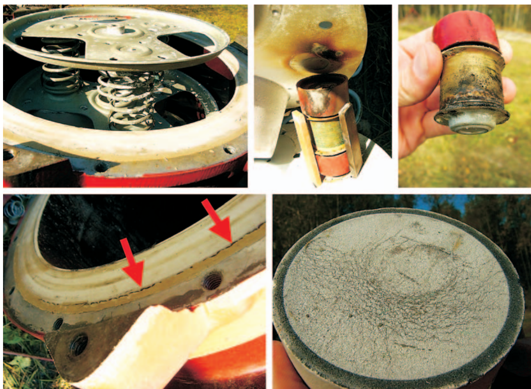
Rys. 4. Elementy odgromnika 220 kV zdemontowanego po stwierdzeniu na jego powierzchni izolacyjnej miejscowych przyrostów temperatury
