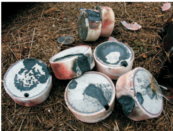
Rys. 3. Uszkodzenia ograniczników przepięć i odgromników w wyniku eksplozji, która wystąpiła podczas stabilnej pracy systemu elektroenergetycznego
