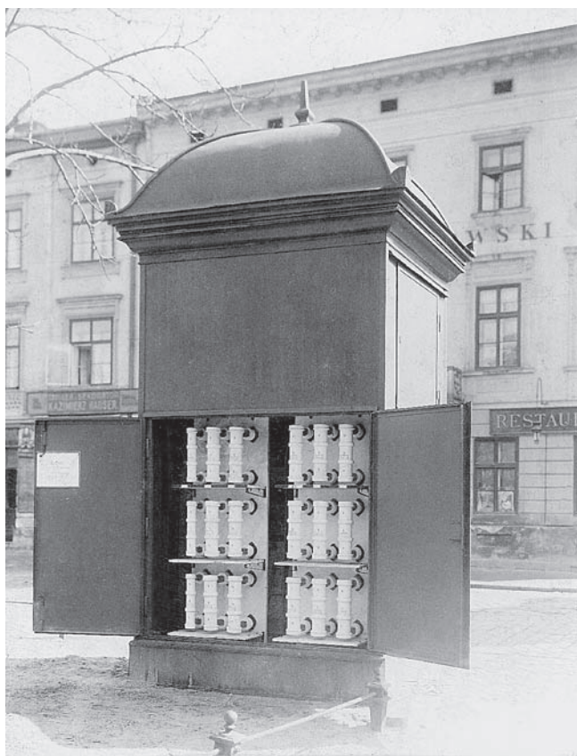
Przedwojenna stacja transformatorowa
