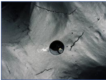
Rys. 10. Widok wad wykrytych badaniami endoskopowymi w korpusie zaworu szybkozamykającego WP turbiny 13K215
