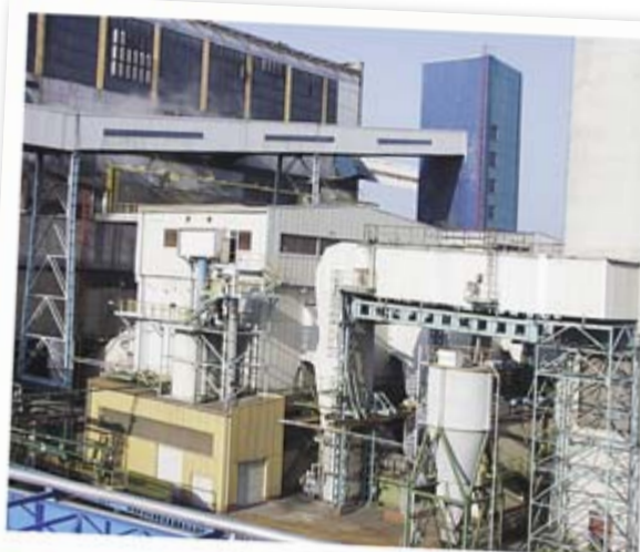
Instalacja odsiarczania spalin bloków 125 MW
