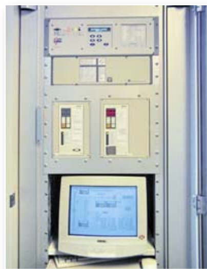
Rys. 2. Szafa B zabezpieczeń bloku nr 11 z komputerem systemu nadrzędnego
