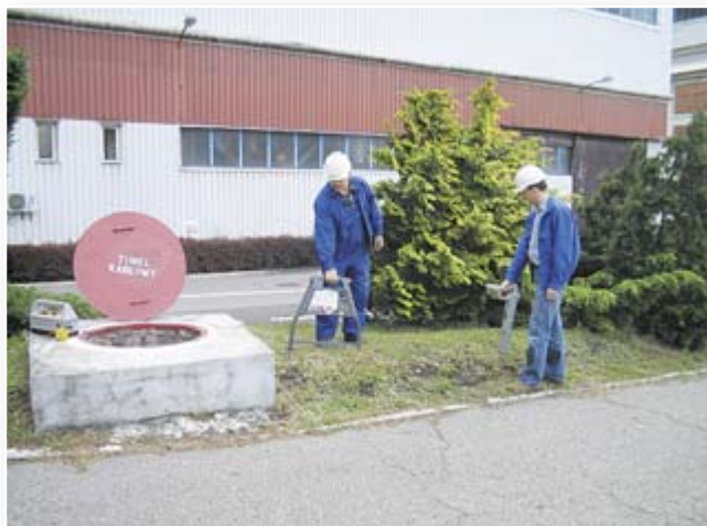
Rys. 2. Lokalizacja uszkodzenia kabla metodą sygnału radiowego
