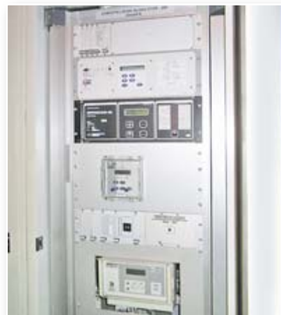
Rys. 1. Szafa A zabezpieczeń bloku nr 12
