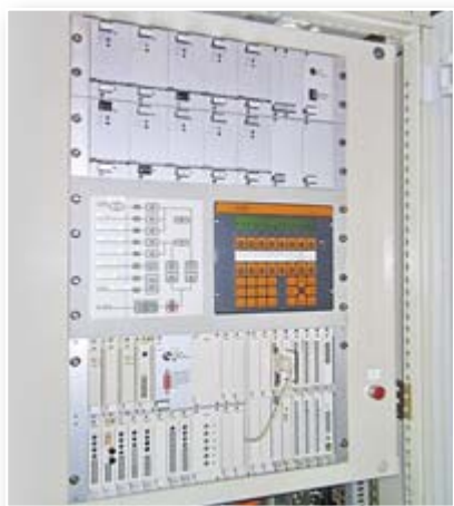
Rys. 3. Szafa regulatora napięcia ETEF-200C
