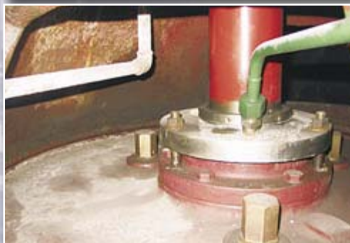
Rys. 5. Przykład zmiany stanu pomp po aplikacji uszczelnień mechanicznych
