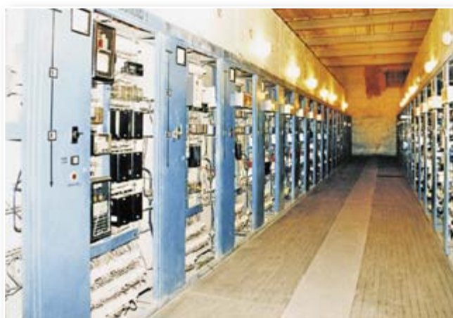
Rys. 2. Rozdzielnia 6 kV potrzeb własnych przed wymianą (typ GIPO)
