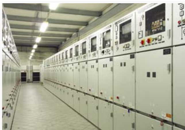
Rys. 3. Rozdzielnia 6 kV potrzeb własnych po modernizacji
