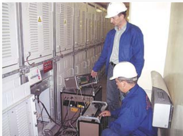
Rys. 1. Lokalizacja uszkodzenia kabla 6 kV generatorem udarowym
