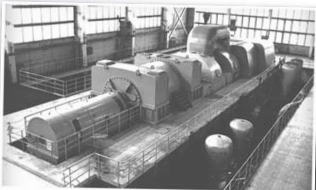
Nowo zbudowany turbogenerator nr 1 o mocy 120 MW. Nowe jednostki ze względu na rozmiar, były ułożone wzdłuż osi hali
