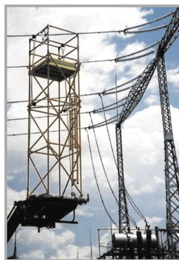
ICOLIM 2004: Wieża izolacyjna pozwala dotrzeć do odciągowych izolatorów szyn
