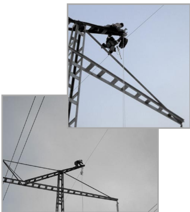
Rys. 6. Wyłożenie przewodu odgromowego na rolki podczas pracy linii 400 kV (prace polskiej brygady wykonywane w Szwecji)
