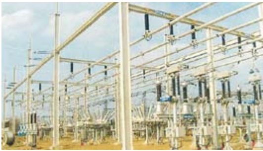
Rys. 6. Rozdzielnia 110 kV z modułami hybrydowymi
