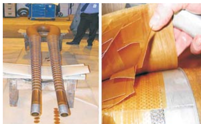
Rys. 2. Ocena stanu technicznego izolacji 40-letnich przekładników prądowych 300 kV
