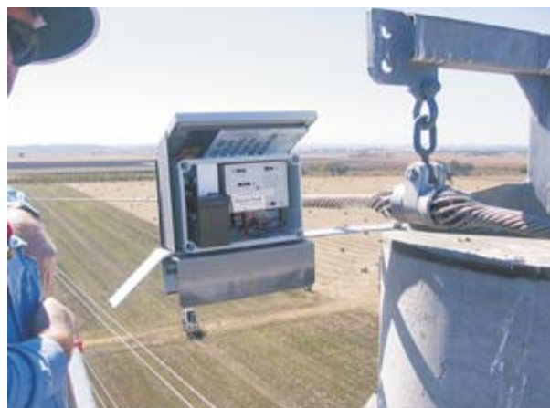
Rys. 5. Urządzenie emitujące ultradźwięki odstraszające ptaki, zamontowane na słupie linii wysokiego napięcia [23]
