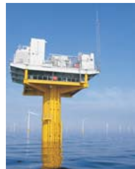
Rys. 3. Stacja elektroenergetyczna na otwartym morzu
