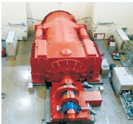
Rys. 10. Widok turbogeneratorsa 2-biegunowego o mocy 1318 MVA firmy ALSTOM
