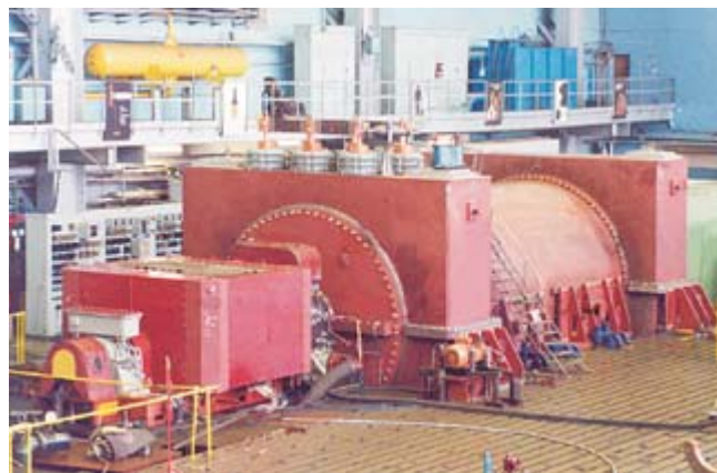
Rys. 12. Turbogenerator wodno-wodorowy firmy Elektrosila w czasie prób
