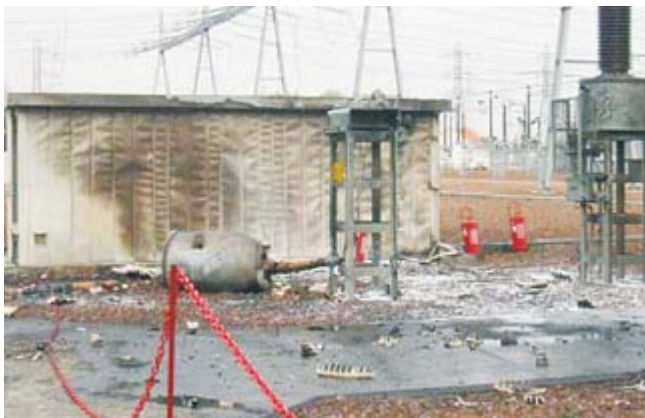
Rys. 5. Skutki eksplozji przekładnika napięciowego 400 kV
