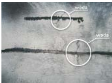
Rys. 9. Wybrane do analizy dwie wady na powierzchni wewnętrznej trójnika
