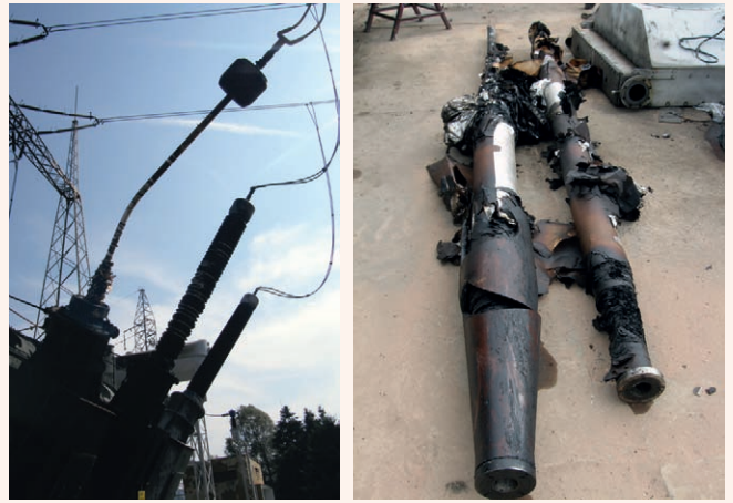
Rys. 1. Skutki uszkodzenia wysokonapięciowego izolatora przepustowego (a) i widok zniszczonej izolacji papierowo-olejowej rdzenia izolacyjnego (b)
