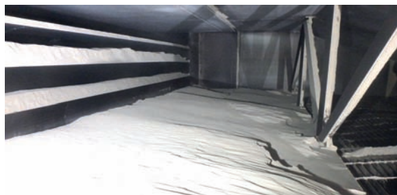
Rys. 4. Akumulacja popiołu na kierownicach spalin
