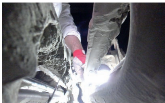
Rys. 7. Przykład akumulacji popiołu na pęczkach konwekcyjnych ECO za SCR
